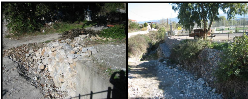
Εικόνα 3-11. Ο Παρορίτης στο σημείο που έχουν δημιουργηθεί οι αθλητικές εγκαταστάσεις (α) ανάντη και (β) κατάντη της γέφυρας
