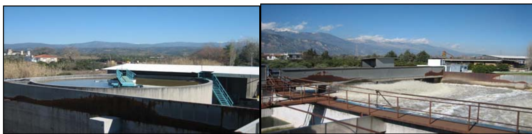
Εικόνα 3-1. Εγκαταστάσεις της μονάδας επεξεργασίας υγρών αποβλήτων του Δήμου Σπάρτης.
