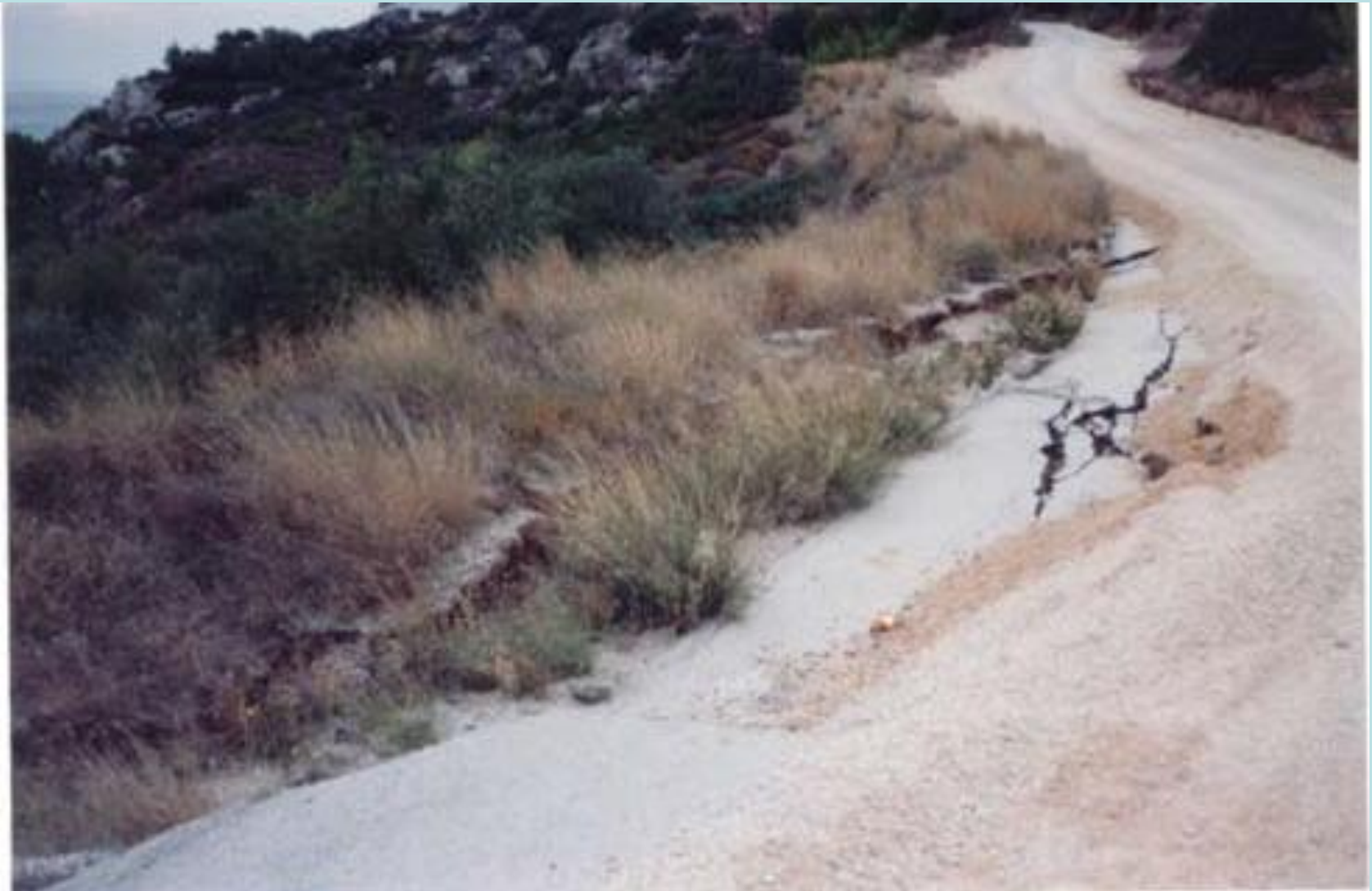
Ρωγμές στο κατάστρωμα οδού εξαιτίας της αστοχίας πρανούς στα κατάντη της περιφερειακής οδού Λουτράκι-Περαχώρα
