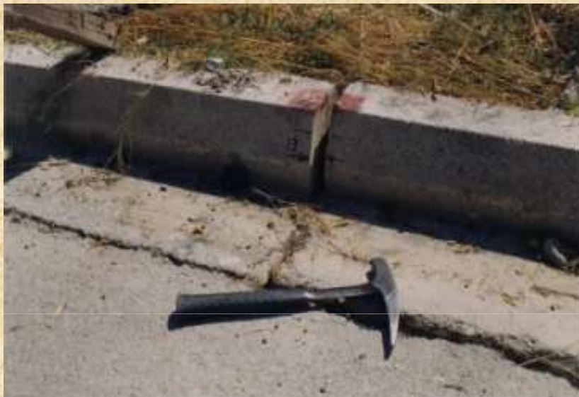
Ρωγμώσεις από την περιοχή Ριζόμυλου
