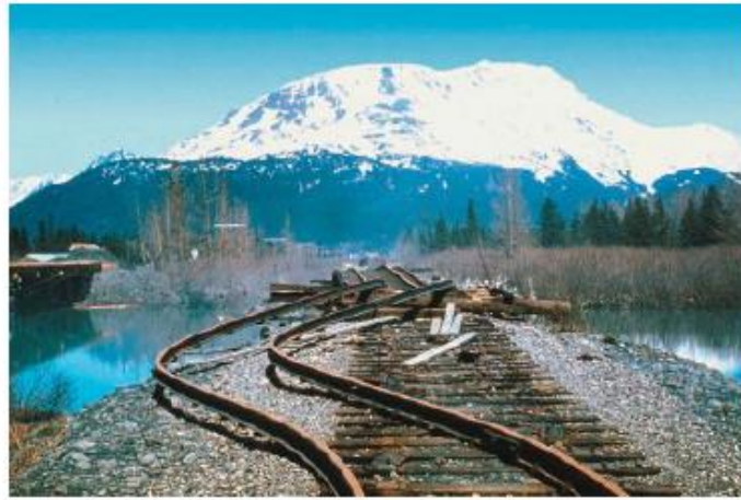
Εικόνα 3.2 Βλάβες στο σιδηροδρομικό δίκτυο από σεισμό ( M=9,2 ) στην Αλάσκα στις 27/03/1964
