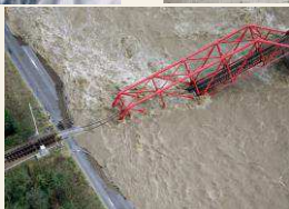
Κατάρρευση αειδροδρομικής γέφυρας, 13/10/2019
