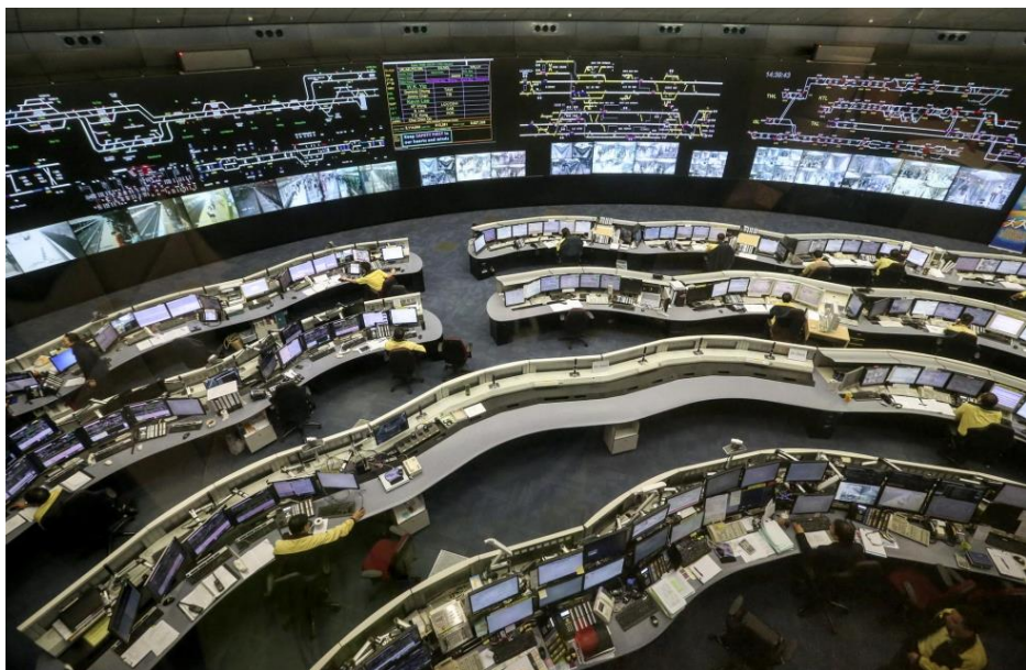
Κέντρο ελέγχου κυκλοφορίας στο Χόνγκ Κόνγκ
