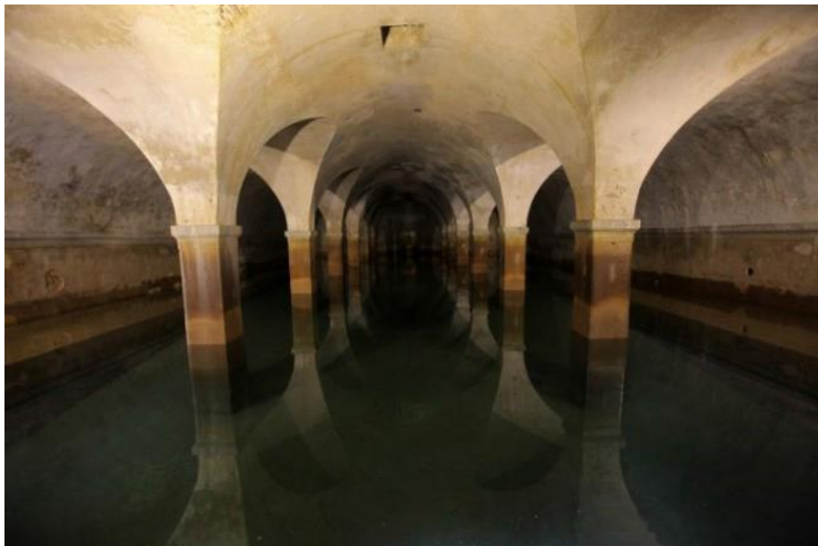
Η μικρή Δεξαμενή ΕΥΔΑΠ στο Κολωνάκι
