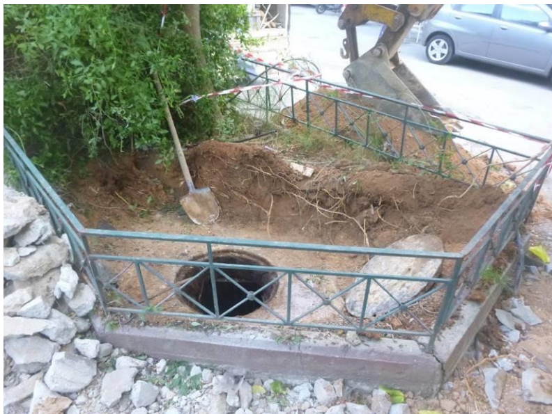
Δεξαμενή χλωρίωσης στην πλατεία Αγ. Δημητρίου Πανόρμου
