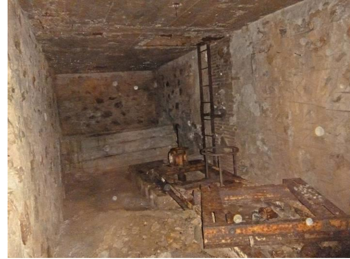
Αφανές υπόγειο φρεάτιο
