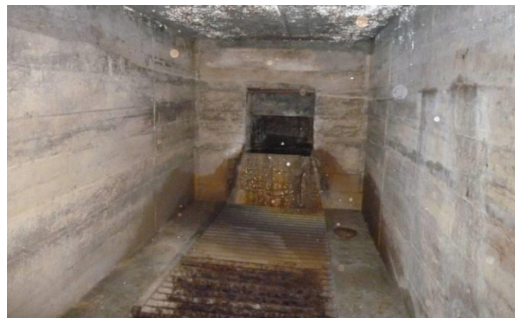
Εσωτερικό προσβάσιμου φρεατίου 40 & φρεάτιο διάσχισης του ποταμού Κηφισού
