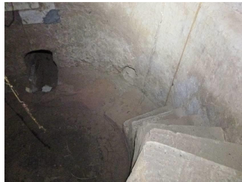
Φρεάτιο και είσοδος δεξαμενής Καθίζησης στο Χαλάνδρι
