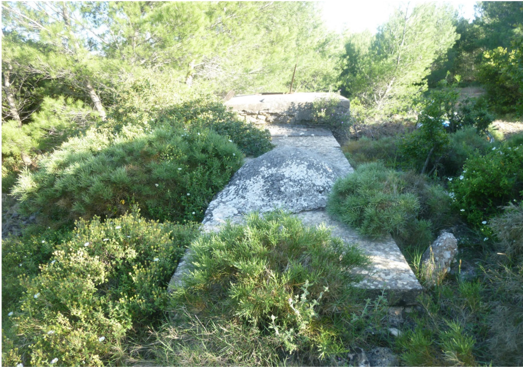
Εικόνα 3.47. Η σύνδεση του υδραγωγείου Κιθάρας στο υδραγωγείο Βαρυμπόμπης (φρεάτιο 327)
