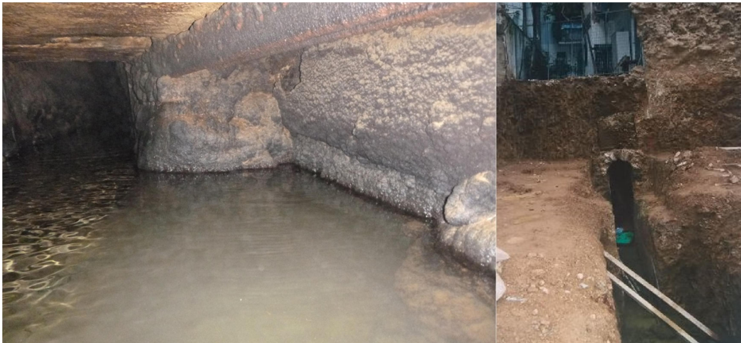
Εικόνα 3.10. Κλειστό θυρόφραγμα προς τον αγωγό εκκένωσης και στα δεξιά, ο παράπλευρος κλάδος όπως αποκόπηκε προ ετών κατά την κατασκευή πολυκατοικίας επί της οδού Φθιώτιδος 22.
