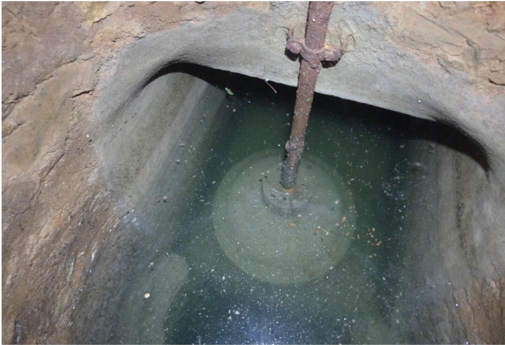
Εικόνα 3.35. Κόφτρα και θάλαμος χειρισμού στον πυθμένα του φρέατος 103 A
