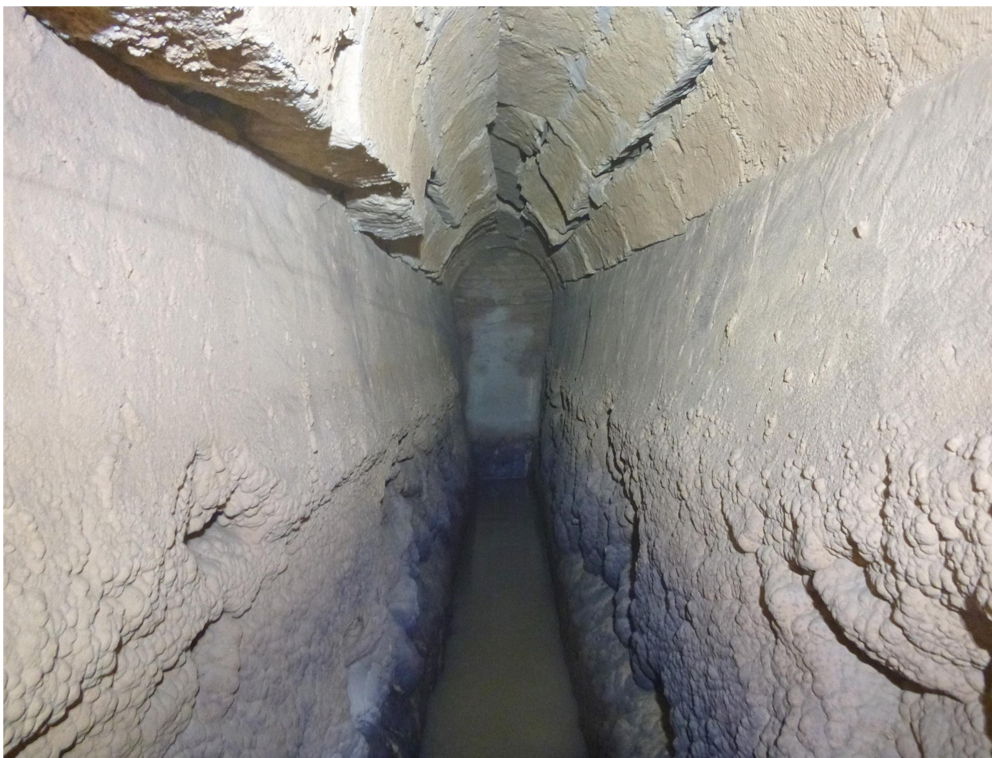
Εικόνα 3.23. Ο κλειστός τοίχος υπερχειλίσης στη θέση του φρέατος 1. Κάτω δεξιά γίνεται η εξαγωγή (λεπτομέρεια Εικόνας 3.22). Η ζημιά στην επένδυση της οροφής προκλήθηκε από την ανάντη αστοχία.
