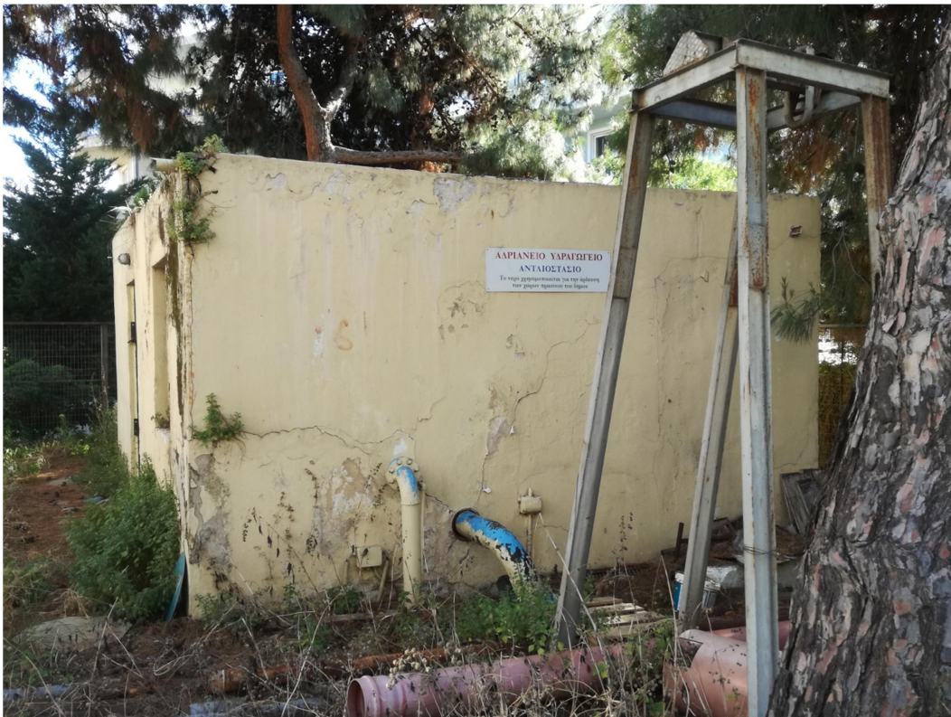
Εικόνα 1.5. Αντλιοστάσιο Δήμου Μεταμόρφωσης δίπλα στο φρέαρ με αριθμό 175
