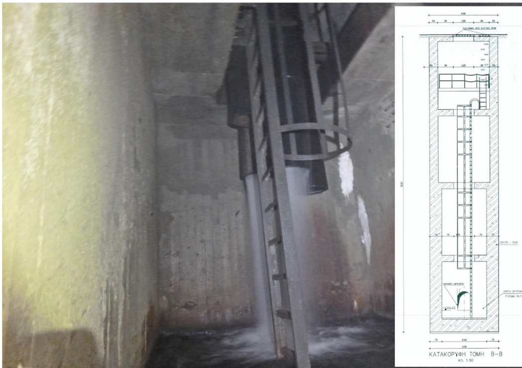
Εικόνα 3.20. Νερό υπερχείλισης στο νέο φρέαρ 18, κατάντη μετρό Πανόρμου (σχέδιο: Κάζος, 2000)
