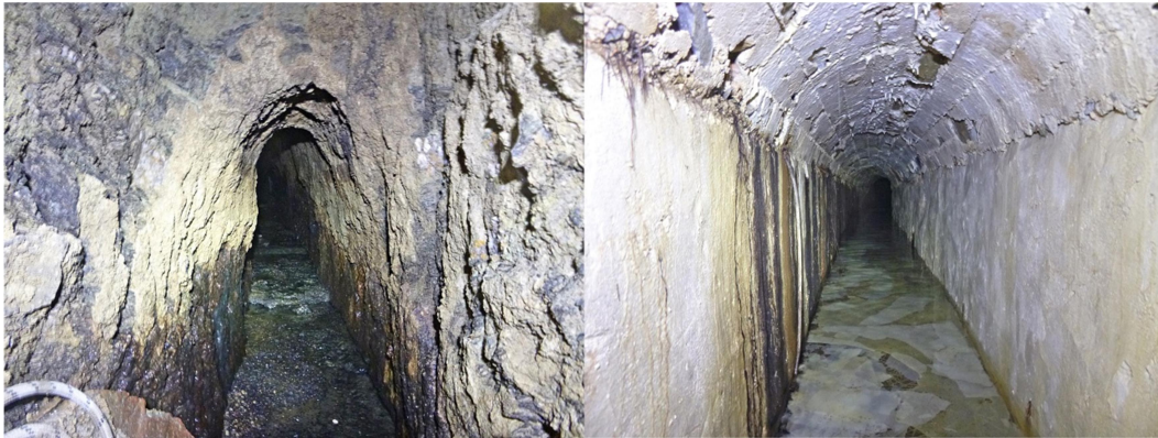
Εικόνα 3.60. Υδρομαστευτικές στοές του υδραγωγείου Πεντέλης σε βάθος 5-6 m (αρχαία, σύγχρονη) πλησίον της Μονής Πεντέλης
