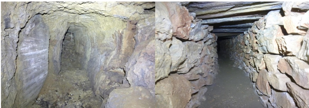
Εικόνα 3.59. Αρχαία διατομή σε κακή κατάσταση, και νεότερο κανάλι
