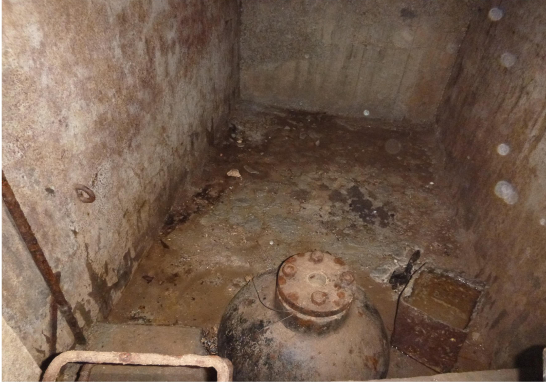
Εικόνα 3.9. Θάλαμος χειρισμού της κόφτρας προς τον αγωγό εκκένωσης
